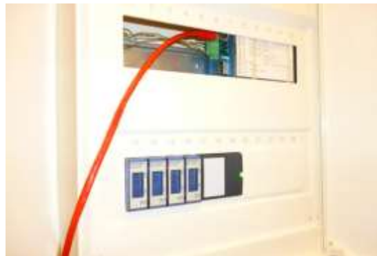
Abb. 9: Elektronische Zähler und Datenlogger zu Messung der Ladung
